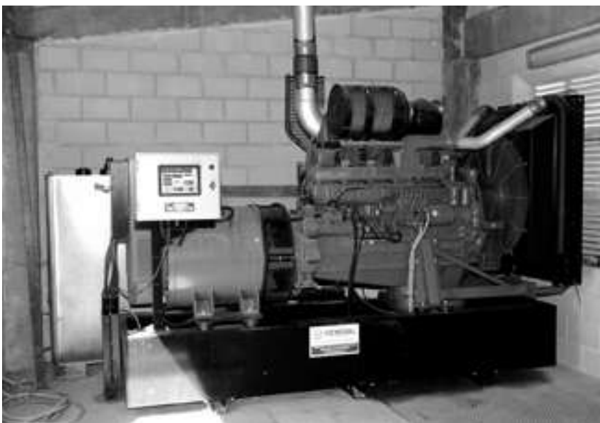
■ Bombeo residuais Santa Cruz
