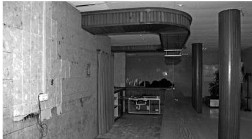
■ As instalacións están totalmente en desuso
