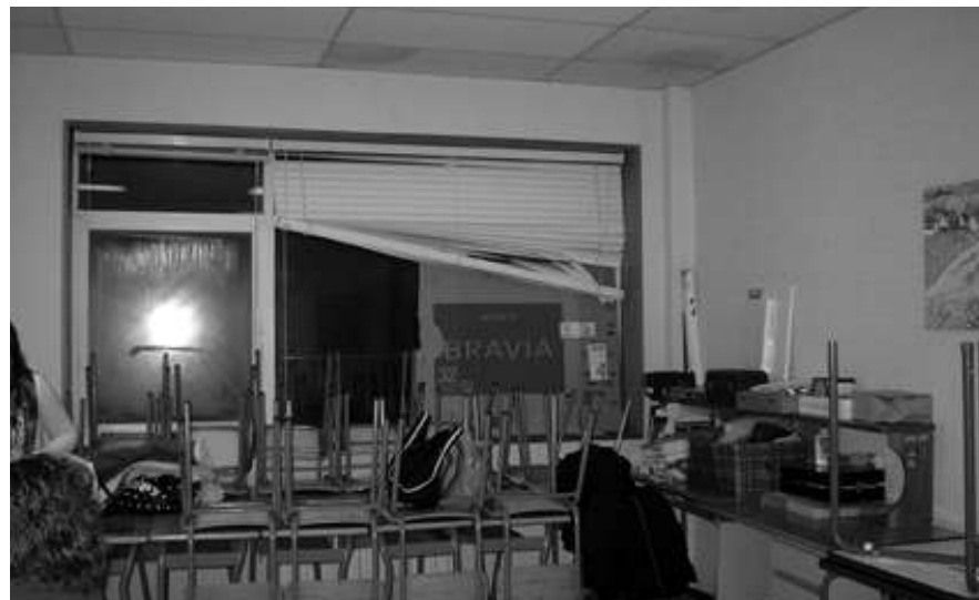
■ As fiestras, así como outros elementos do edificio encóntranse moi deteriorados
