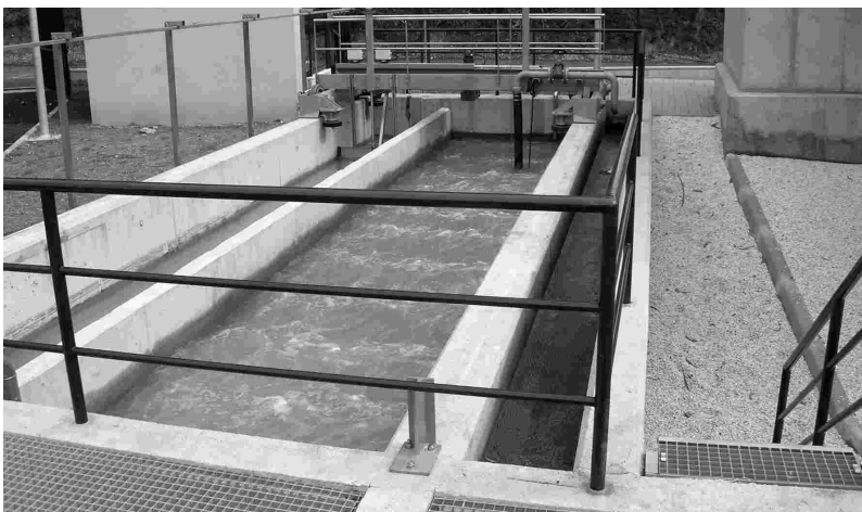
■ O tratamento terciario das augas permite a súa cloración antes do verquido
