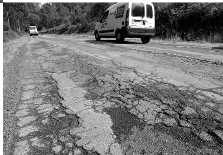
■ Estrada autonómica Arillo - Oleiros, en moi mal estado
