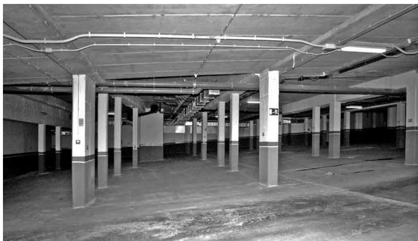
■ O aparcadoiro público, con capacidade para 100 vehículos, disporá de varios accesos para os usuarios
