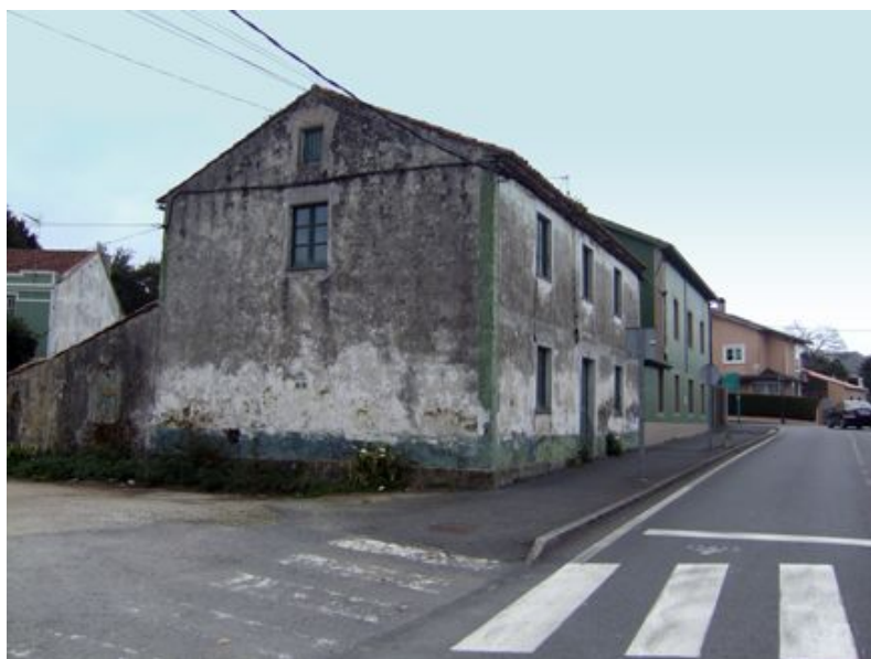
■ Patrimonio considera que estas casas forman parte do patrimonio arquitectónico do municipio malia que é evidente o seu estado de deterioro
