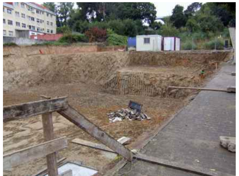
■ Inicio das obras de 27 vivendas de protección nun lugar privilexiado no centro de Santa Cruz, fronte ao hotel Portocobo
