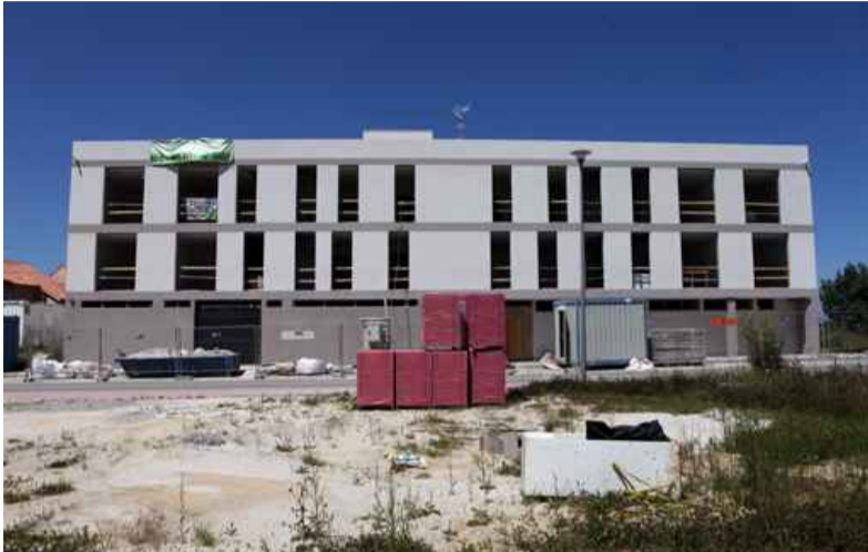
■ Vista da obra do edificio de 8 vivendas protexidas que se está a construír en Oleiros, na urbanización Obelisco
