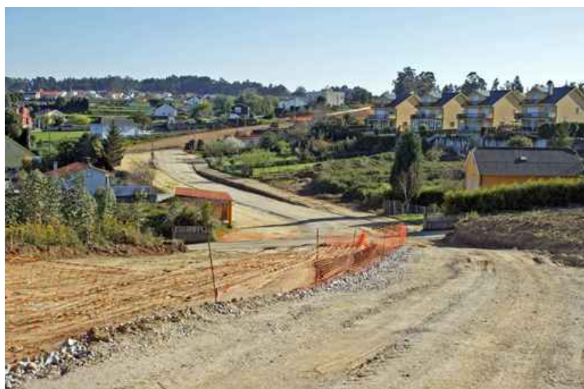
■ No último tramo da vía Ártabra, en Lorbé, o trazado da calzada xa se distingue á perfección
