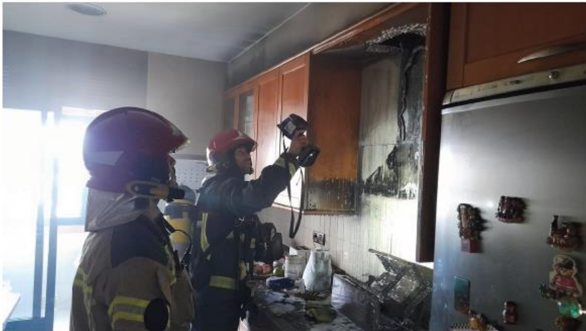
Estado de la cocina tras el incendio. LOC
