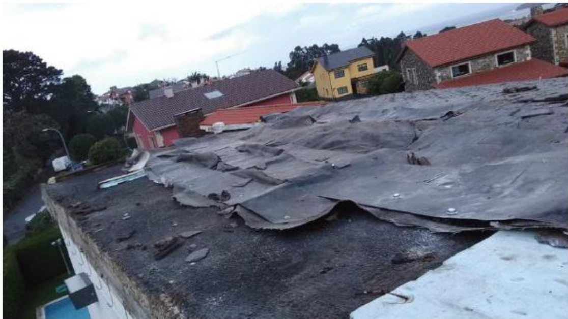
Placas sueltas del tejado de una vivienda de Montrove
