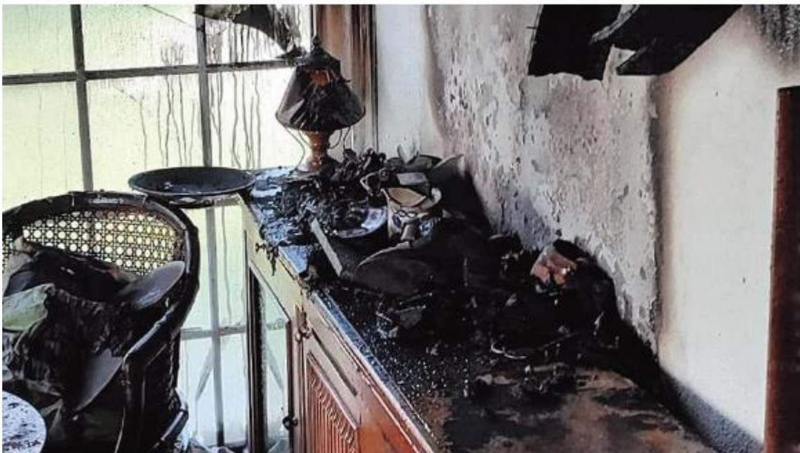
Daños tras el fuego en la vivienda
